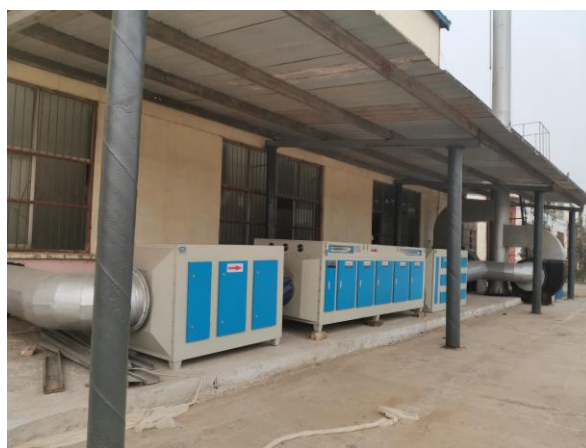
废气处理设施
